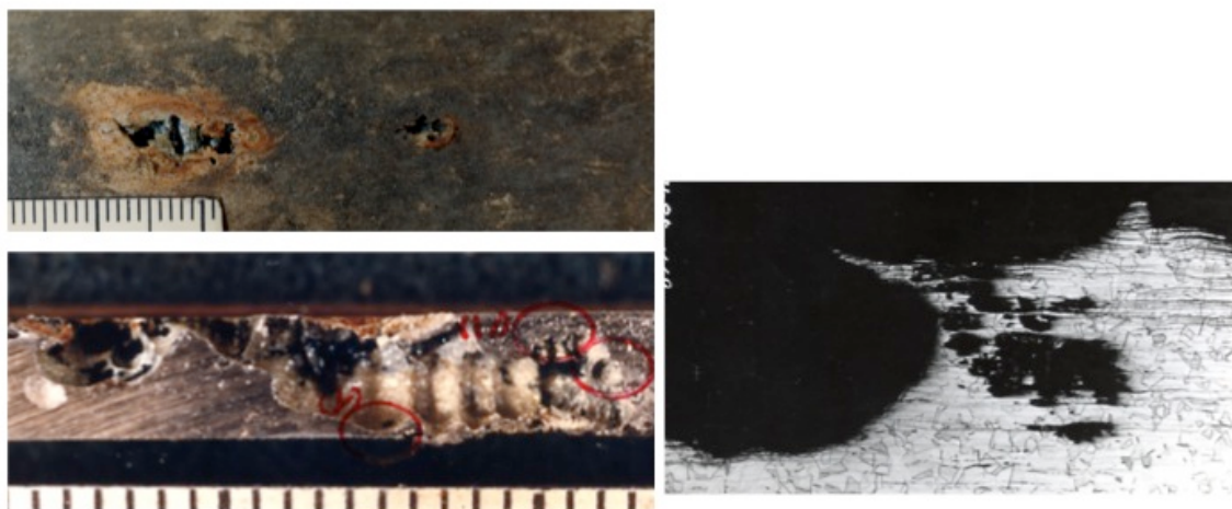
a) 部品外観 b) 板厚断面 c) 腐食地点の断面拡大
