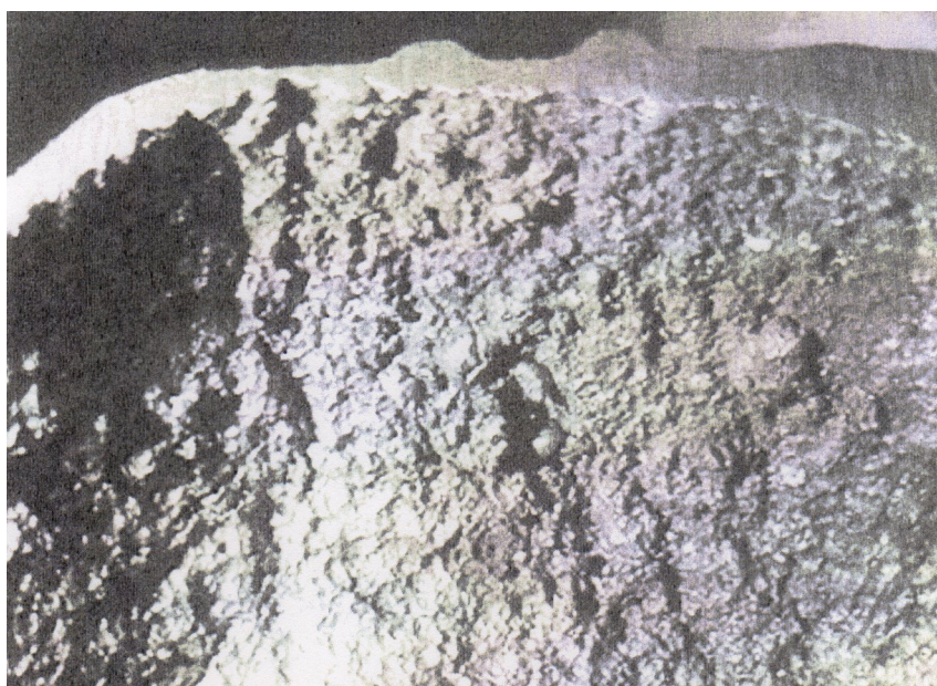
図 4-26b 損傷表面の拡大部
